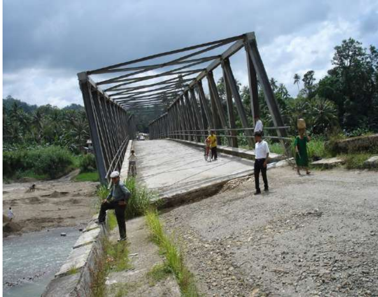
Gambar 3. Jembatan yang abutmentnya rusak akibat likuifaksi
